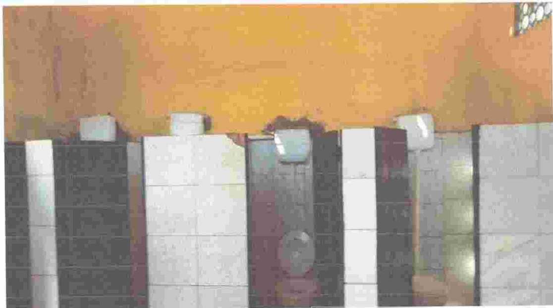
Imagem 3 – Banheiros com problemas de infiltrações.
