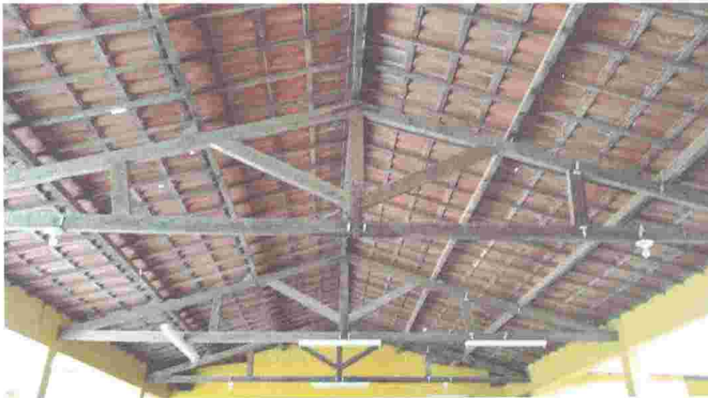
Imagem 2 – Telhado com presença de cupins e necessitando de retelhamento.
