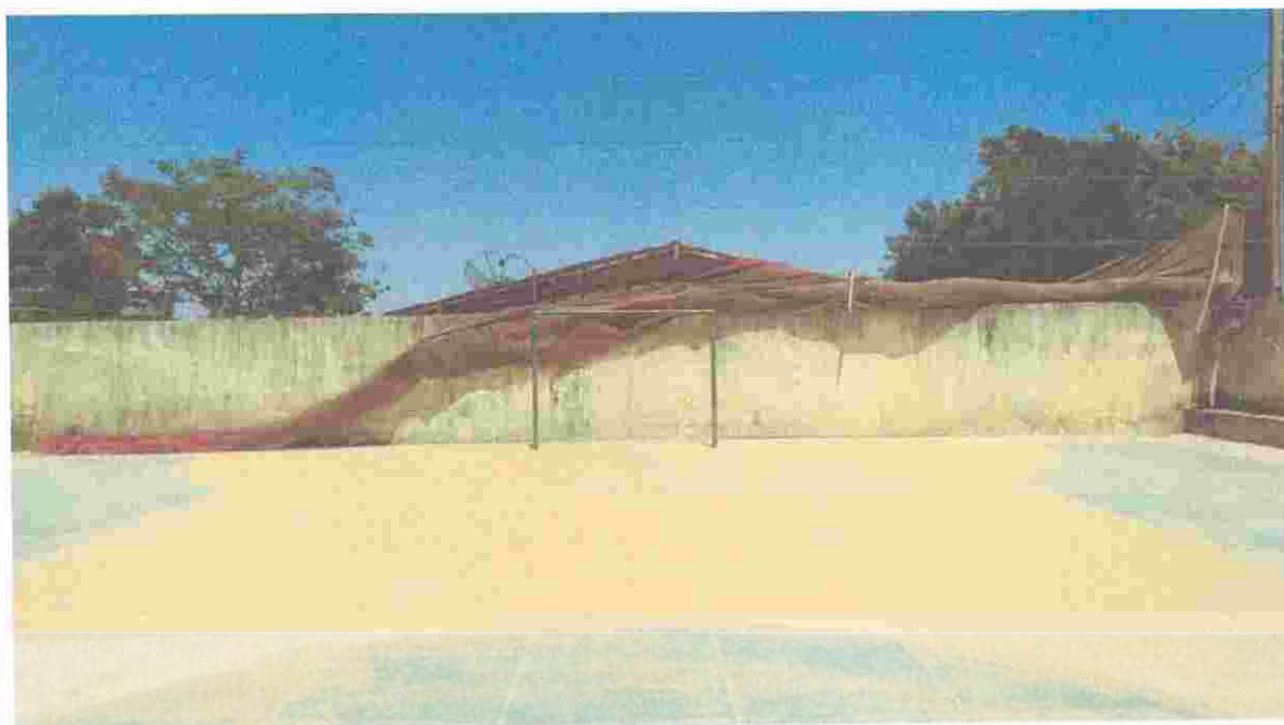
Imagem 5 – Quadra necessitando de cobertura.
