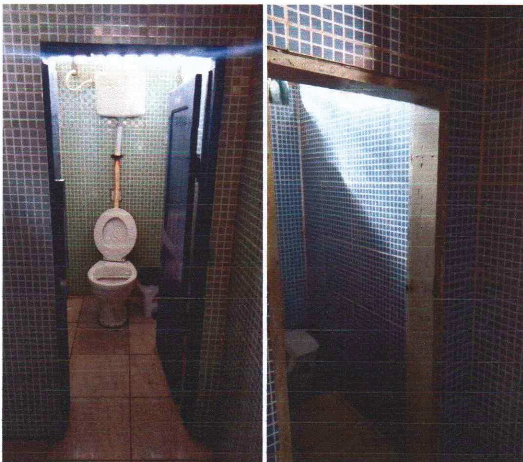
Imagem 5 – Banheiros apresentam defeitos e estão em dimensões inferiores a mínimas.
