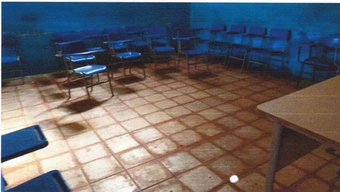
Imagem 3 – Piso antigo e danificado.
