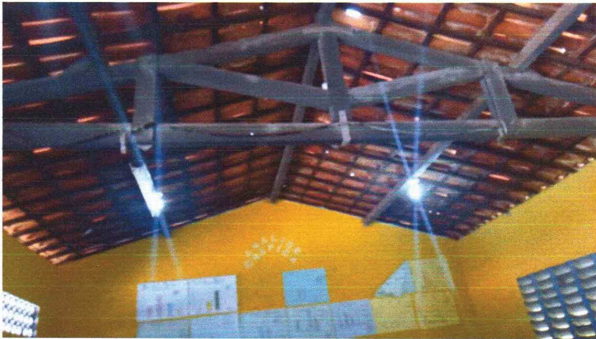
Imagem 2 – Telhado com presença de cupins e necessitando de retelhamento.
