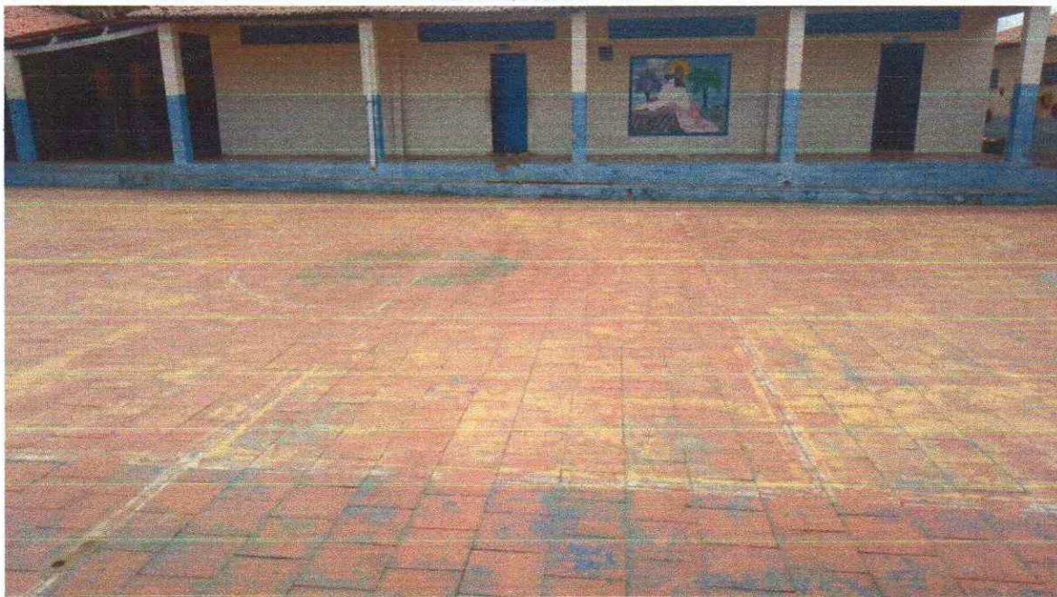
Imagem 4 – Quadra sem cobertura e com piso cerâmico danificado.
