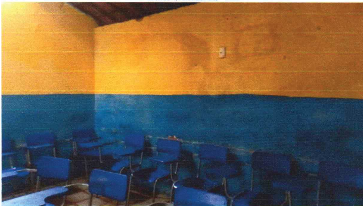
Imagem 6 – Salas com infiltração.
