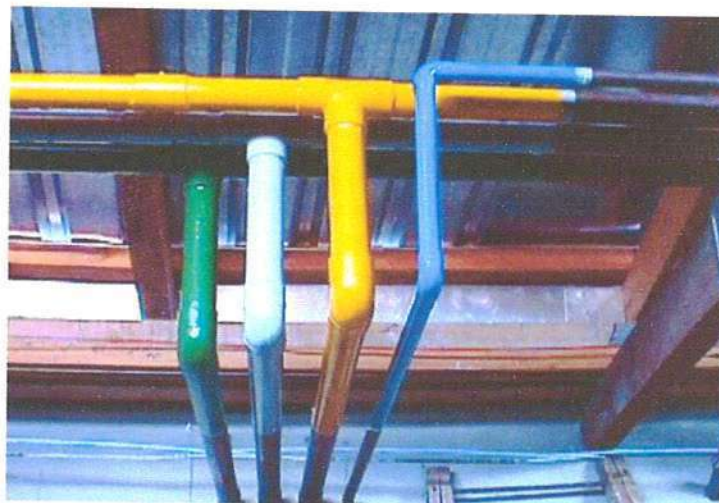
Figura 3 – Pintura padrão de identificação de segurança da rede de distribuição de gases hospitalares.
