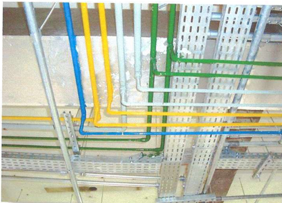
Figura 2 – Fixação para tubulação rígida e cota de segurança com relação as demais tubulações.
