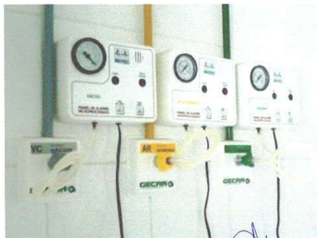
Figura 5 – Painéis de alarme de monitoramento de pressão de utilização instalado na enfermaria.
