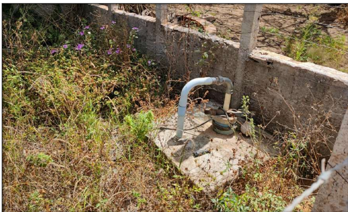
Figura 9 - Poço profundo existente
